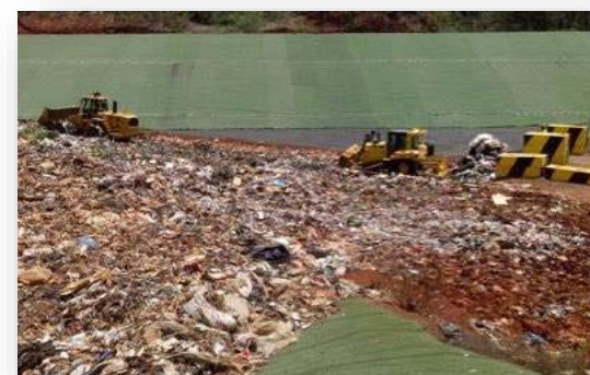
Centre de stockage
